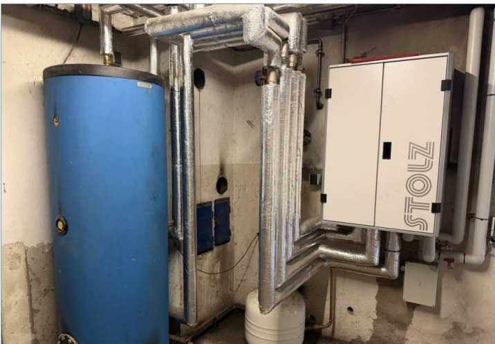
Fernwärme Stadtwerke Radolfzell aus 2019
